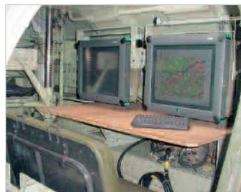
Figuur 7: BMS-computers ingebouwd in een M577
